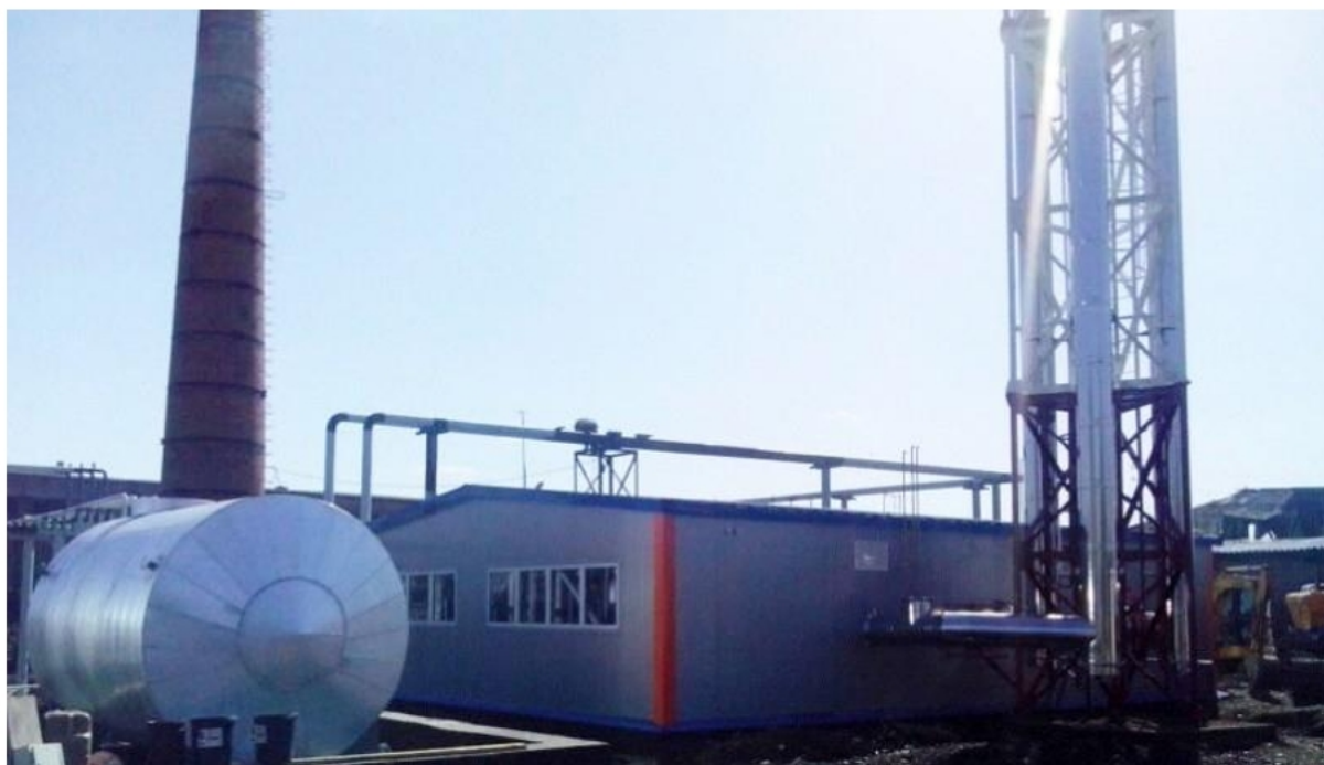
Рисунок 11 – Общий вид блочно-модульной котельной номинальной производительностью 5,55 МВт
